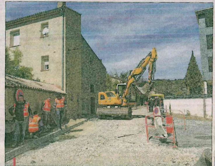
Entamés en avril 2018, les travaux d'enfouissement des réseaux d'eau et d'électricité s'achèvent. Il ne restera plus que la voirie à finaliser avant la livraison prochaine. /PHOTO I.B.
