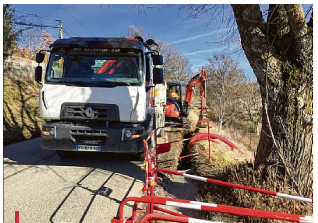
À Thoard, les travaux quartier des Bourres ont permis l'enfouissement des lignes, ce qui permet plus de sécurisation pour les automobilistes et un visuel plus agréable du paysage de cette route. /PHOTO DR
